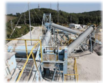
振動篩～ベルトコンベヤ
